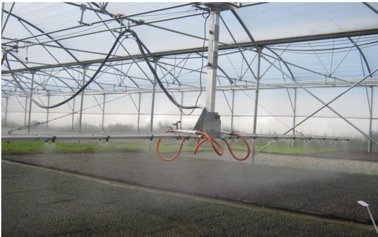
شکل ۱۲- سیستم بازوی متحرک جهت آبیاری سینی‌های کشت
